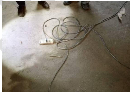
现场使用多孔插线板
